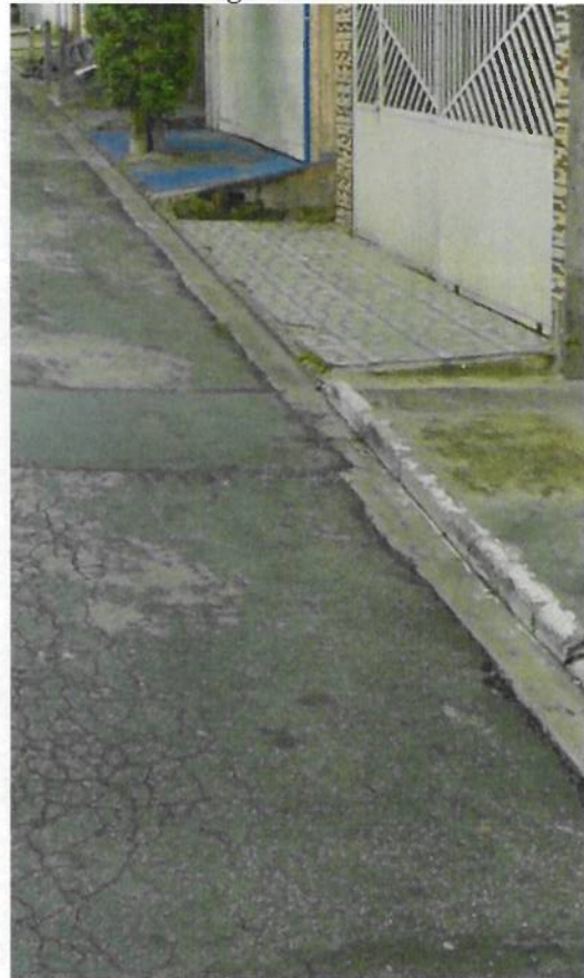
Imagem 5 – Sistema de drenagem por gravidade
